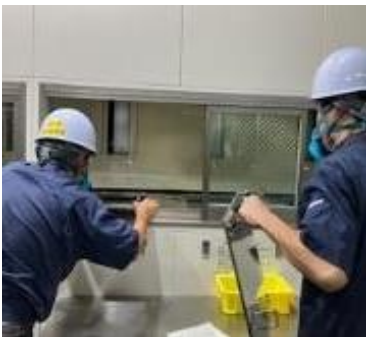
有機溶剤 拡散防止処置
